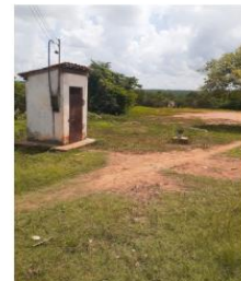
Figura 3: Casa de Quadro de Comando/Popo Povoado Serraria Foto: Kleber Veras Cordeiro
